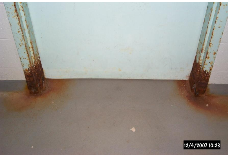
Rusted Door Frame
